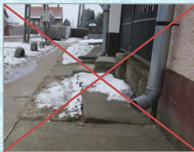
Szabálytalan csapadékvíz kivezetés
