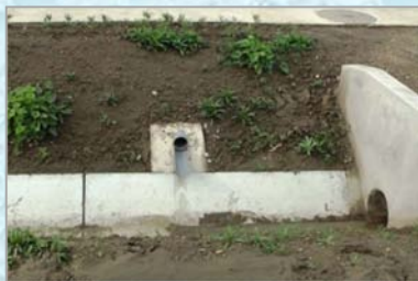
Szabályos csapadékvíz kivezetés
